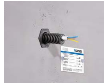
Wanddurchführung durch Brandschutzwand aus Beton.
