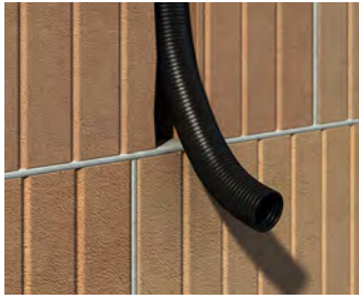
Mauerwerk mit Rohraustritt.
