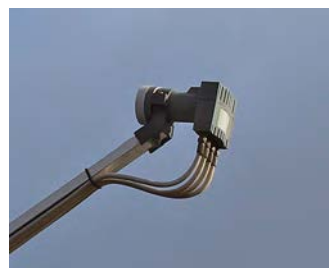
Hier werden 4 Koaxial-Leitungen für den Empfang angeschlossen.
