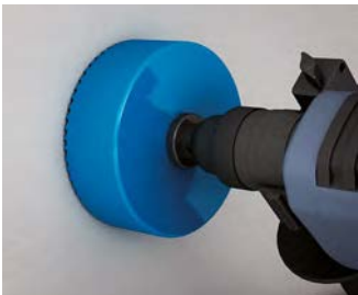
Installationsöffnung mit einem Fräser \varnothing 120 mm (z. B. Bi-Metall Fräser Art.-Nr. 1082-20) erstellen.
