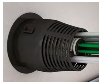
Mischbelegung von Leitungen und Rohren.
