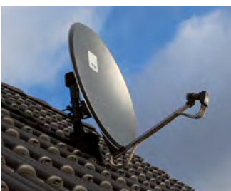
Anschluss einer digitalen Satelliten-Empfangsanlage.
